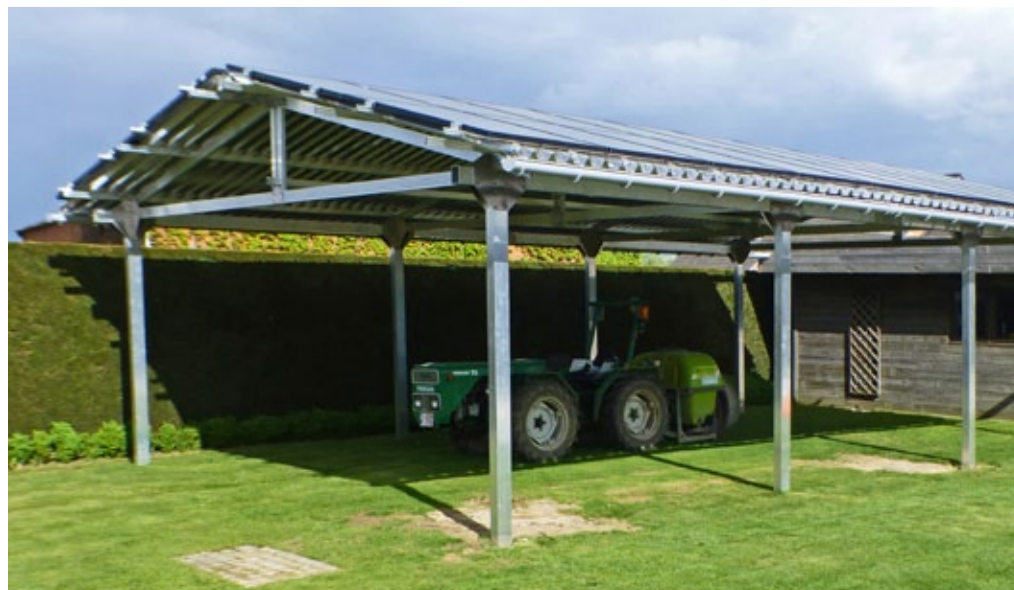
WATERDICHTHE SOLAR CARPORT MET TRAPEZIUM PROFIELEN
